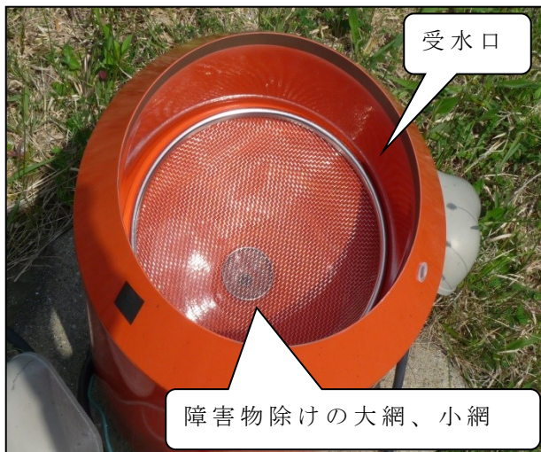
写真 2 転倒ます型雨量計の上部
